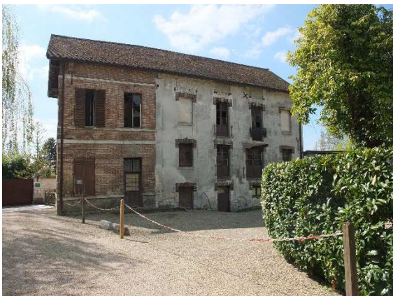
Moulin de Giverny très dégradé
